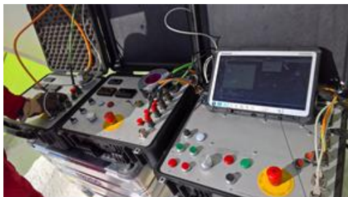
Windenkontrollbox / Winch control box
